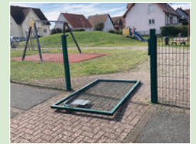
Portail du terrain de jeux arraché
